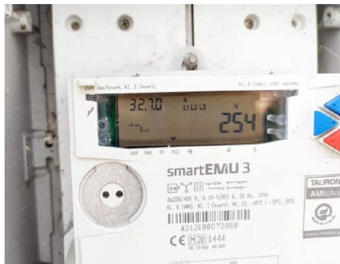
Fotografia 5. Napięcie sieci NN w słoneczne popołudnie, podczas tzw. walki falowników
