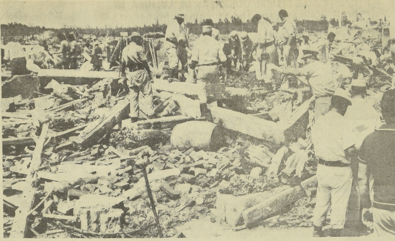
YA SE TRABAJA EN LA RECONSTRUCCION. LOS ESCOMBROS SON RETIRADOS Y DONDE REINO LA DESTRUCCION Y LA DESOLACION, VOLVERA A VIBRAR LA VIDA DE UNA COMUNIDAD TRABAJADORA
