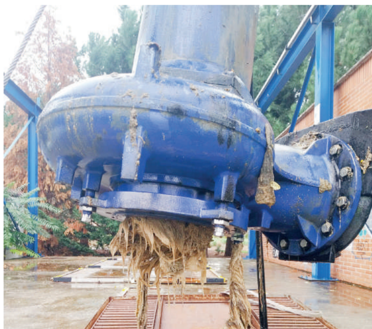
Atasco de toallitas en las instalaciones de Arroyo. ENA
