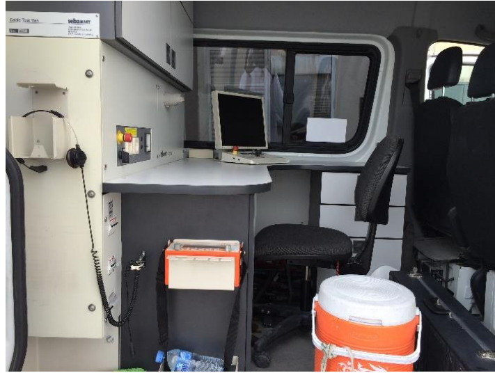
شكل 21-27 : الأجهزة المتنوعة داخل السيارة جهاز VLF / وجهاز المسار (Burn unit 15 KV) ومولد النبضات ( Surge 3/6/12 KV ) داخل السيارة
