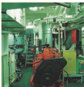
a casa das máquinas engine room
